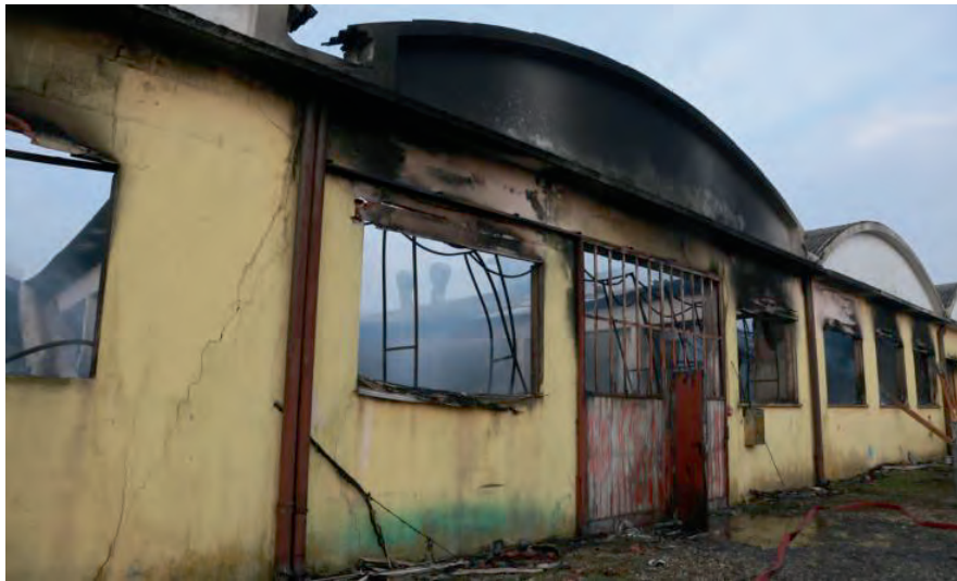
CAPANNONI INCENDIATI CON PRESENZA DI MATERIALI CONTENENTI AMIANTO
