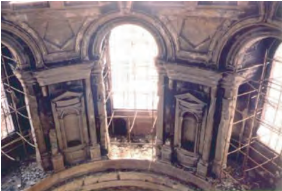
INTERNO DEL LOGGIATO DEL TAMBURO AL LIVELLO III, ALL'INDOMANI DELL'INCENDIO
